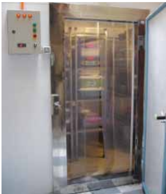
Foto 16: Cámara de almacenamiento en frío.
